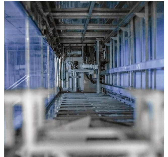
In Kürze eröffnet das Unternehmen ein Technikum, in dem u.a. eine industrielle Vorbehandlungsanlage für Tauch- und Spritzanwendungen installiert ist und den gesamten Prozess großtechnisch abbildet. Die Anlage steht dann Kunden für Verfahrensprüfungen zur Verfügung und wird intern für die Produkt- und Verfahrensentwicklung genutzt. Fotos: Chemische Werke Kluthe
