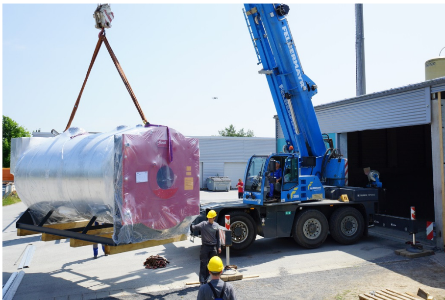
Bild 2: Ankunft des neuen YADOS Erdgaskessels mit fünf MW Leistung in Kamenz.
